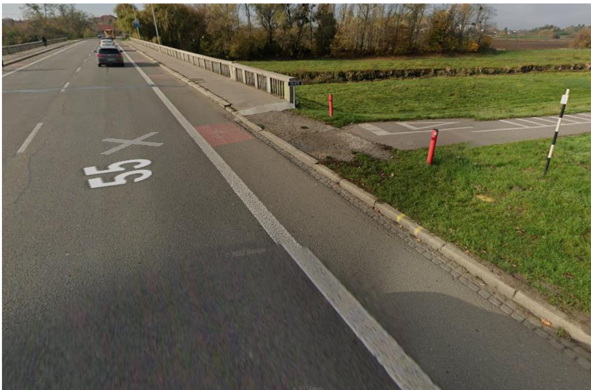
Chybějící mimoúrovňové křížení silnice I/55 (zdroj: google.com)
